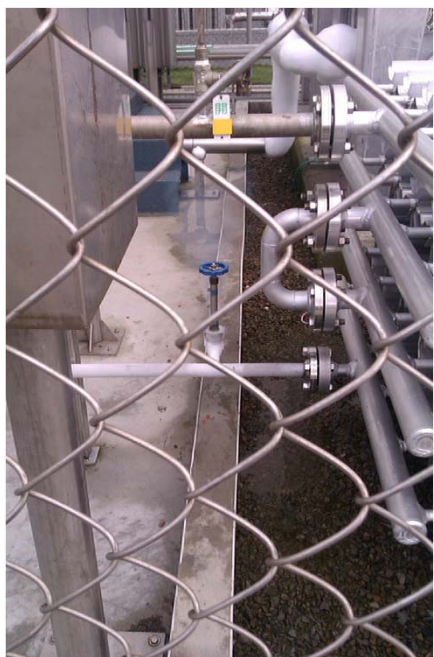
1. 巡廠時發現不明液體流出
